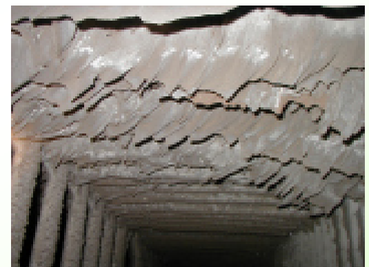
Depositionen an Überhitzerbündeln einer altholzbefeuerten Dampfkesselanlage
