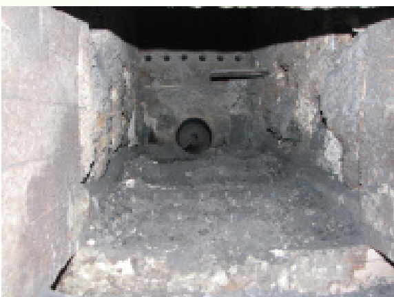
Schlackenablagerungen bei der Verbrennung halmgutartiger Biomasse
